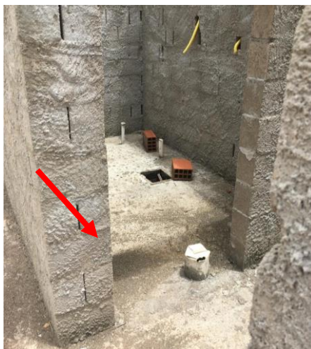
Figura 10 – Instalação Sanitária Executada Incorreta na porta do lactário
